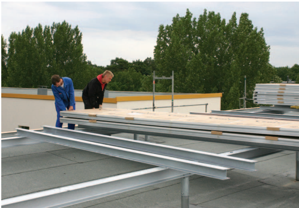
Die Kollektorunterkonstruktion für Flachdächer von Plattenbauten ist ein inzwischen standardisiertes Element
